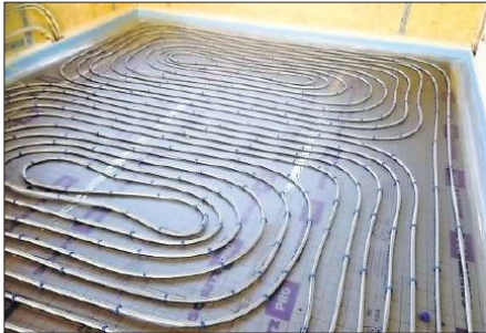
So sieht eine von der Firma Gassmann installierte Fußbodenheizung aus. Foto: Gassmann
