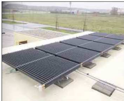
Luftabsorber einer Eisheizung montiert auf einem Flachdach. Foto: st
